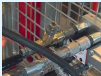
Das Öl sucht sich immer den leichtesten Weg. Durch die unterschiedliche Fertigung der Zylinder steigt der Systemdruck in beiden Kolben nicht gleichzeitig.
