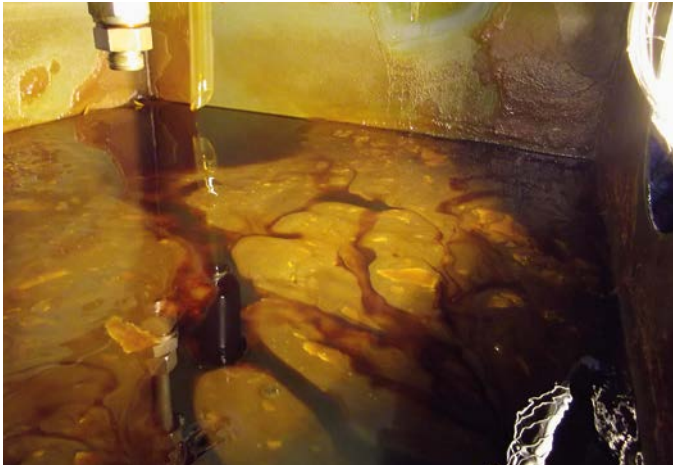
Ablagerungen im Tank durch Öl-Vermischung
