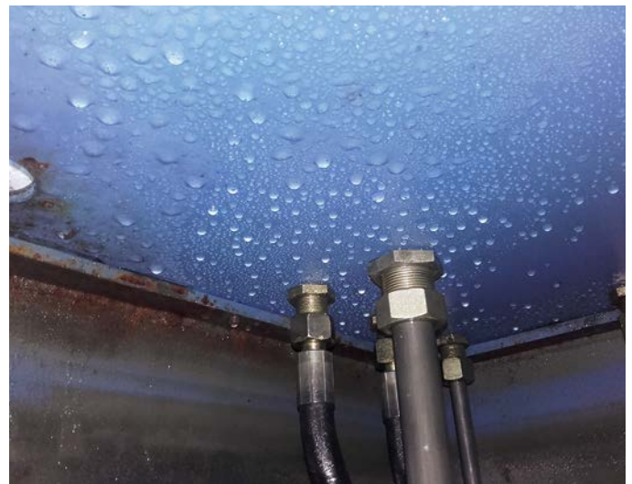
Kondenswasser im Hydraulik-Tank
