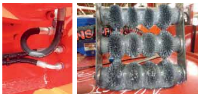
Auch wenn die Schlauchleitungen durch zu enge Biegeradien nicht anforderungsgerecht verlegt wurden (li.), kann es zu Beschädigungen kommen. Eine Verschmutzung durch Feststoffe (re.) am Magnetfilter.
