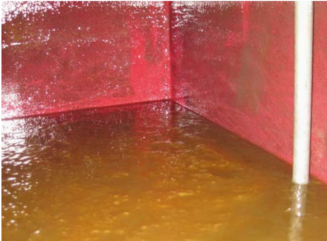
Tank-Additiv, Abbau durch Wasser
